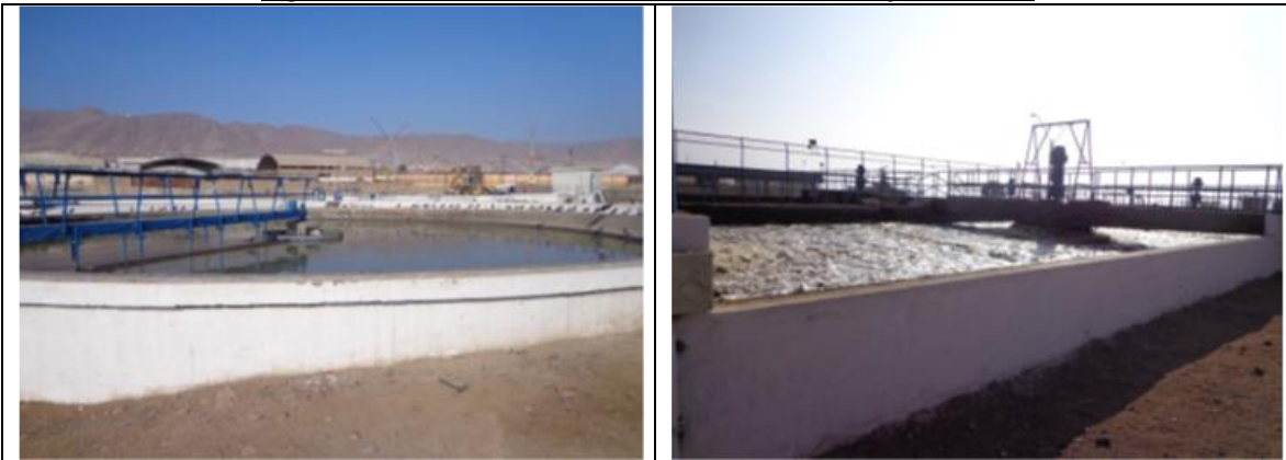
Figura 6: Unidades de Sedimentación Primaria y Aireación
